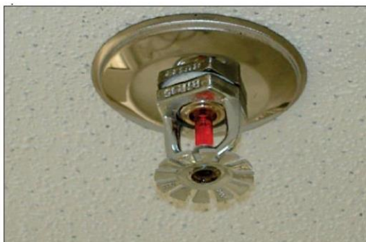
Figura 9: Exemplo de um Chuveiro Automático ou Sprinklers
